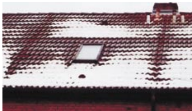
Attēls 4.3. Aukstuma tilti starpsienu un jumta savienojuma vietās. Jumta siltumizolācija šajās vietās ir tik slikta, ka sniegs šeit jau ir nokūsis (avots: Auraplan)
